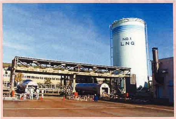
港エネルギーセンター
