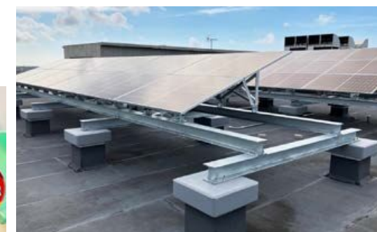
太陽光発電設備の導入
